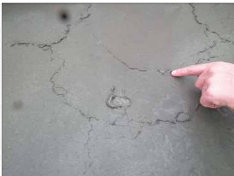
Fig. 6. Plastiske svindrevner i overfladen af fundament.
