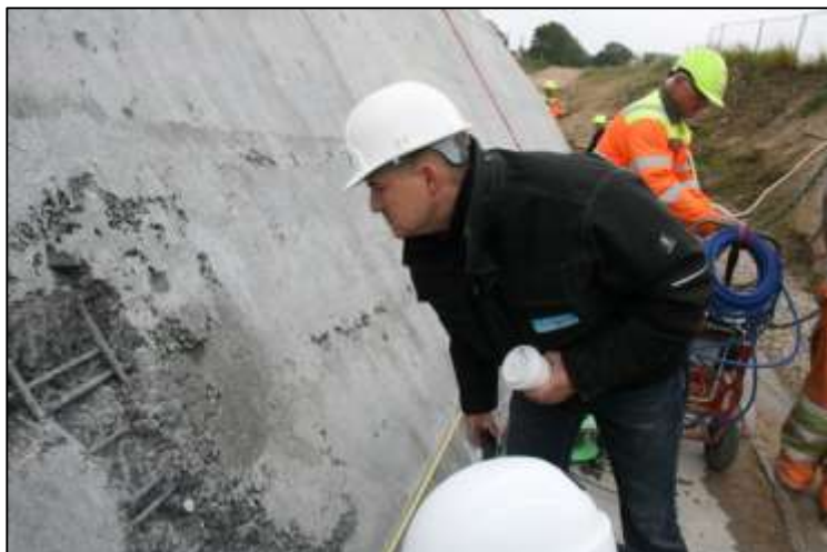
Fig. 16. Stenrede og blotlagt armeringsjern observeret på ydersiden af brovæg efter ophugning.
