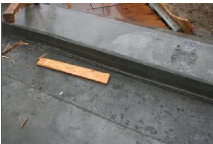
Fig. 12. Luftindeslutninger blev efter afformning observeret i overfladen af brodækkets kontrabanketter.
