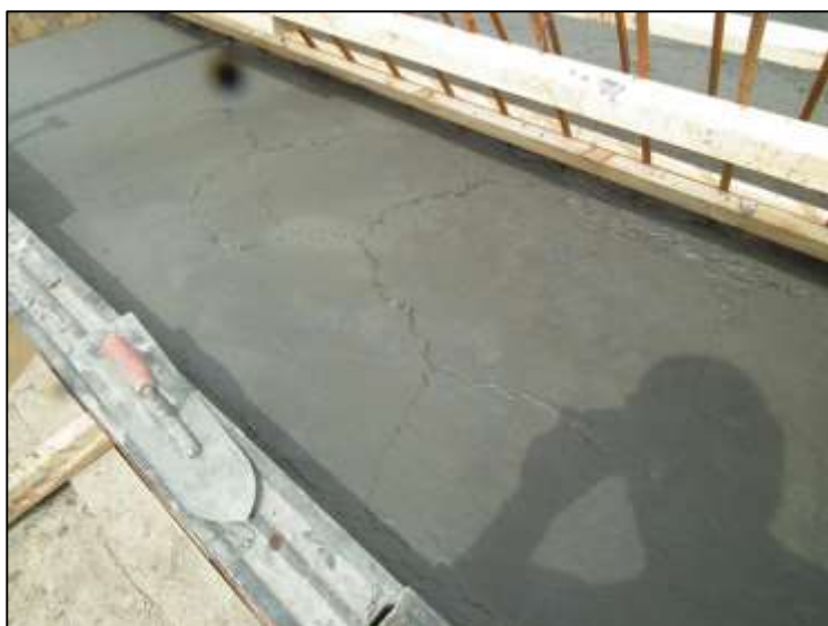
Fig. 5. Plastiske svindrevner observeret i overfladen af fundament.
