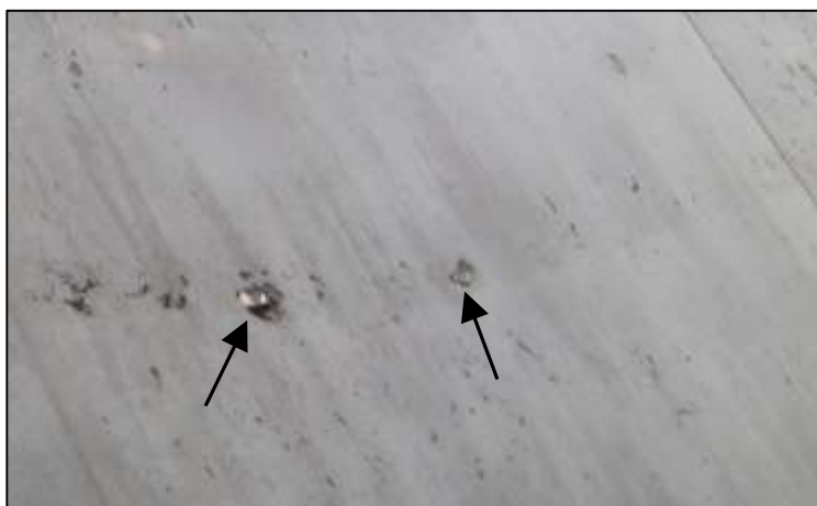
Fig. 10. Eksempler på synlige afstandsklods (markeret med pile) observeret på ydersiden af brovæg.
