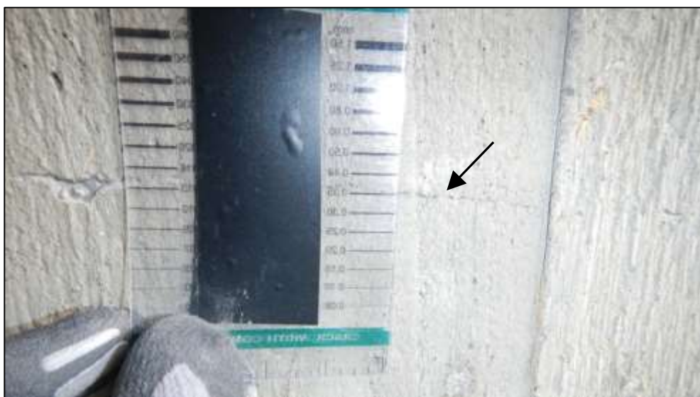
Fig. 27. Detalje fra inderside af østvæg. Linje af luftporeansamling er markeret med den sorte pil.
