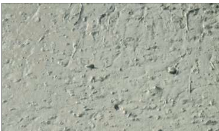
Fig. 7. Øverst: Stålfibre ses i overfladen af den udstøbte beton i brodækket. Midt: Ingen stålfibre at se i overfladen støbt mod bræddeforskalling. Nederst: Ingen stålfibre at se i overfladen støbt mod stålform.
