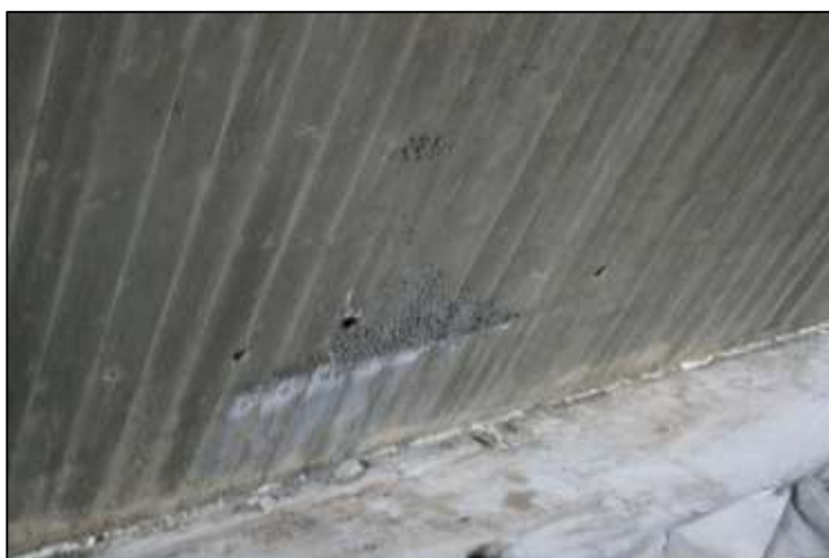
Fig. 15. Stenrede. Udfældet calciumkarbonat ses umiddelbart neden for stenreden.
