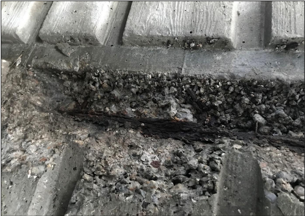
Fig. 4. Væg med større stenrede. Betonens manglende tæthed medfører en reduceret beskyttelse af den indstøbte armering, hvilket her har ledt til omfattende armeringskorrosion i området.
