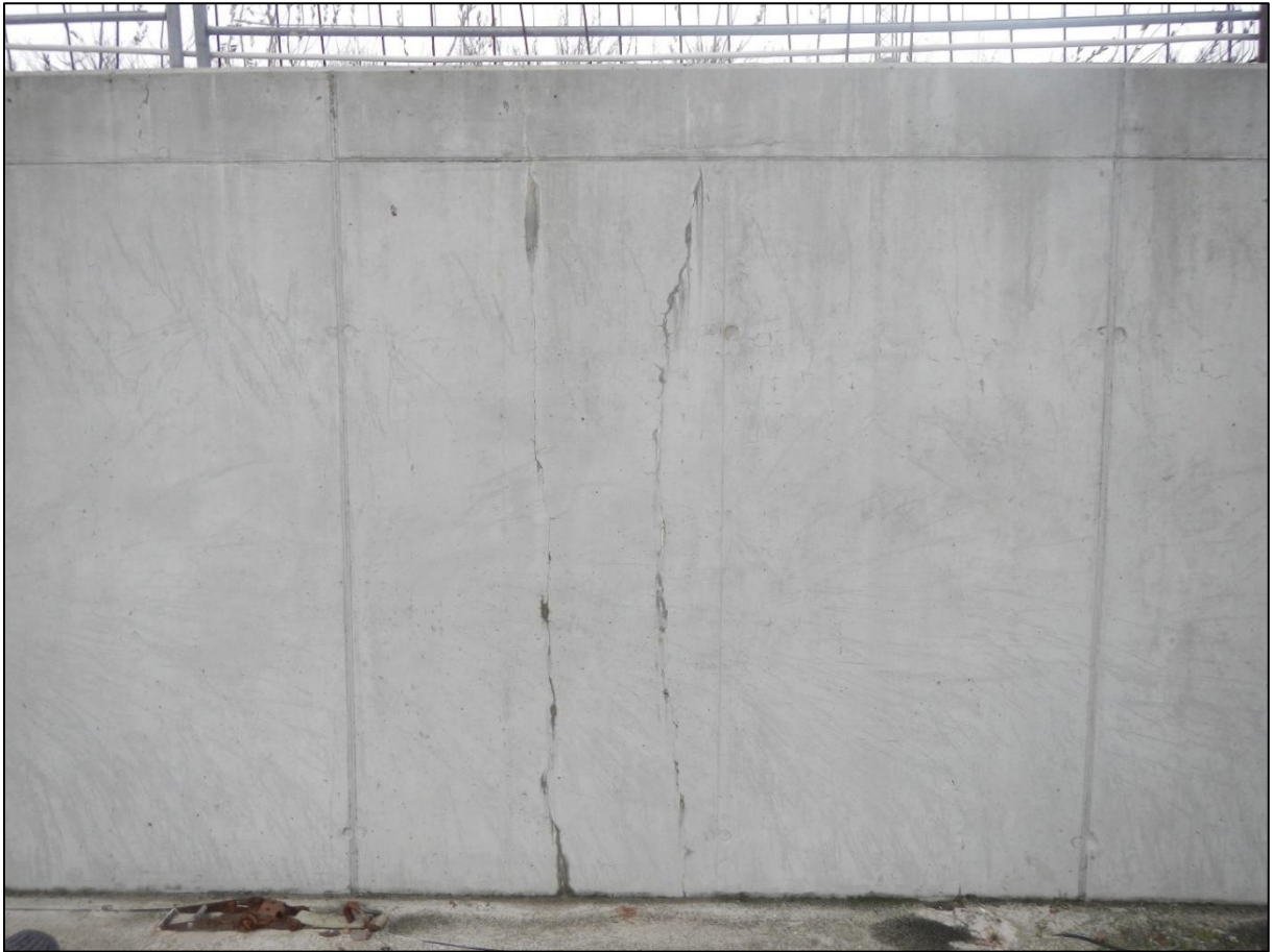
Fig. 1. Eksempel på termorevner i væg, som er opstået fordi væggen er støbt sammen med et allerede hærdet fundament, hvor temperaturforskellen mellem betonen i væg og fundament har været for høj.
