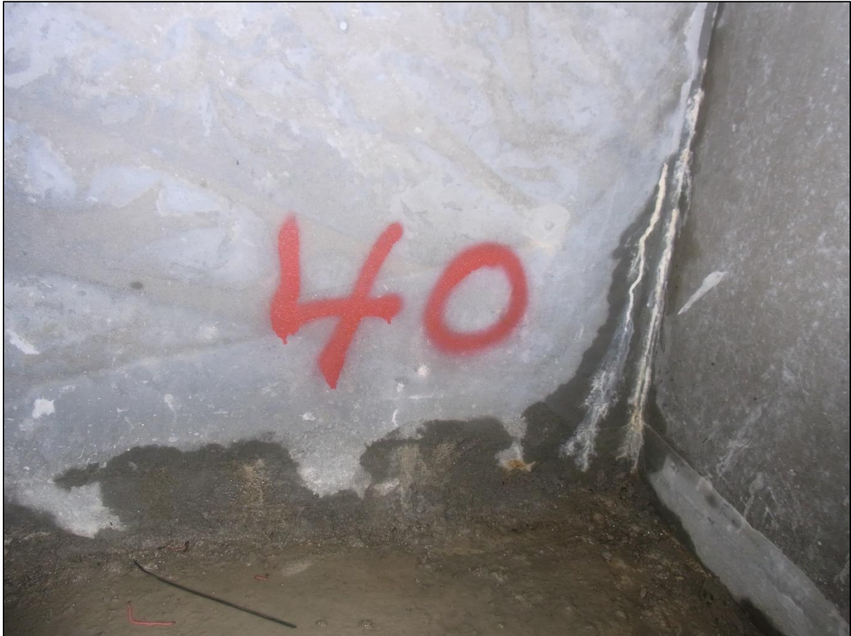
Fig. 5. Eksempel på utæt lodret støbeskel i hjørnesamling mellem to vægge, hvor der ses hvide udfældninger i støbeskellet.
