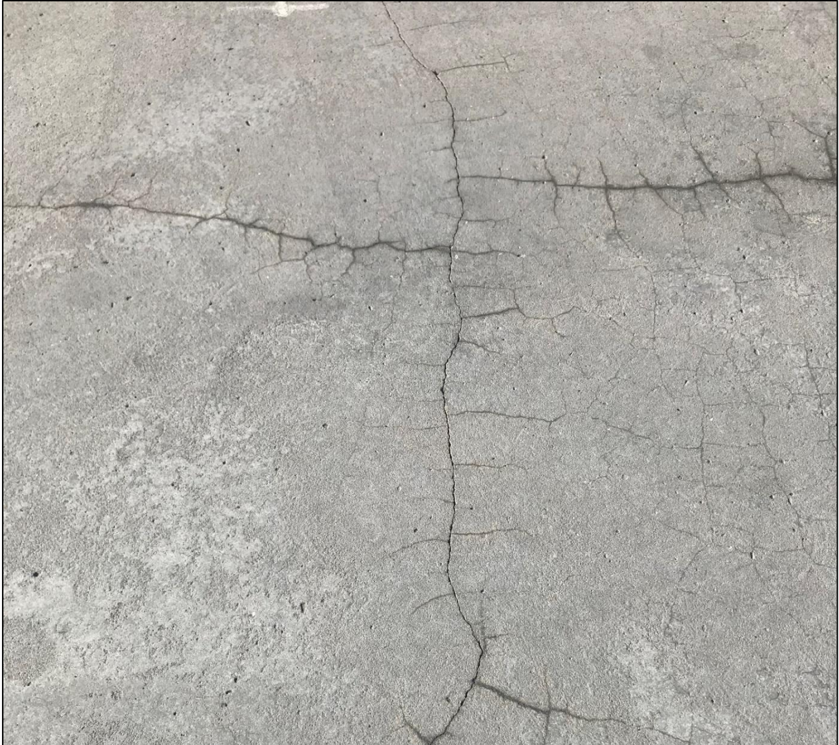
Fig. 3. Eksempel på plastiske svindrevner i parkeringsdæk, som blev støbt under varme og blæsende forhold.
